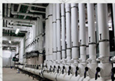
Προμωνωμένοι συλλέκτες και σωληνώσεις Aquaplus Prins σε ξενοδοχειακό συγκρότημα 5*
